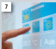
Steuerungskomponenten für die Gebäudeautomation.
